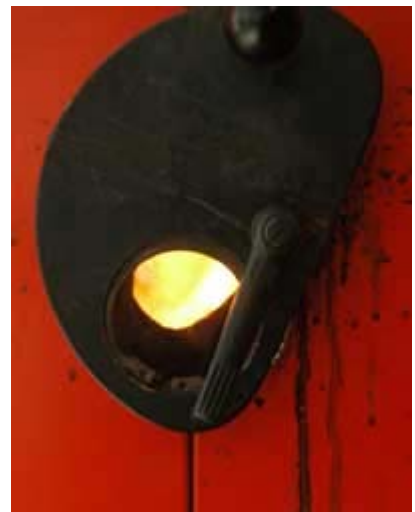
Flisbrännaren går för fullt i pannrummet på Kalix naturbruksgymnasium.
